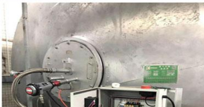
项目：广东茂名石化废气焚烧
