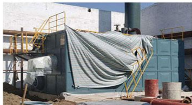
项目：呼和浩特建信热力14MW
