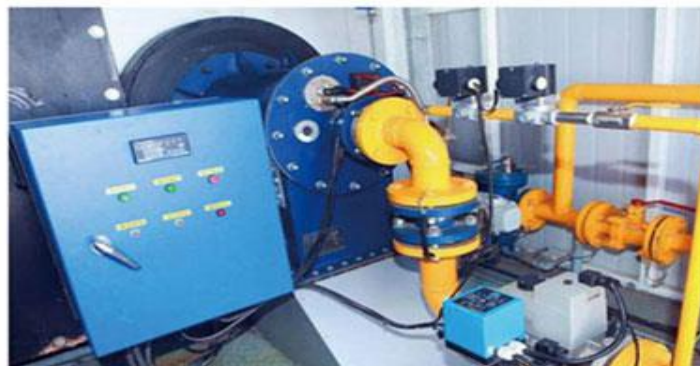
项目：河北信诺立兴化工4.2MW
