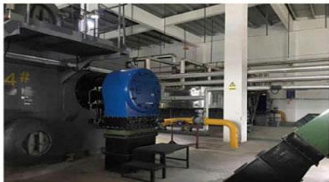
项目：河北大化集团17.5MW
