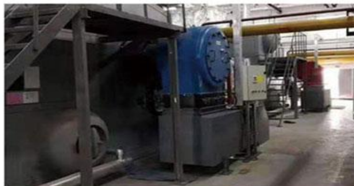
项目：大庆石化21MW
